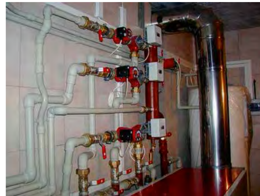
Актуальным на данное время является автоматизированный индивидуальный тепловой пункт
